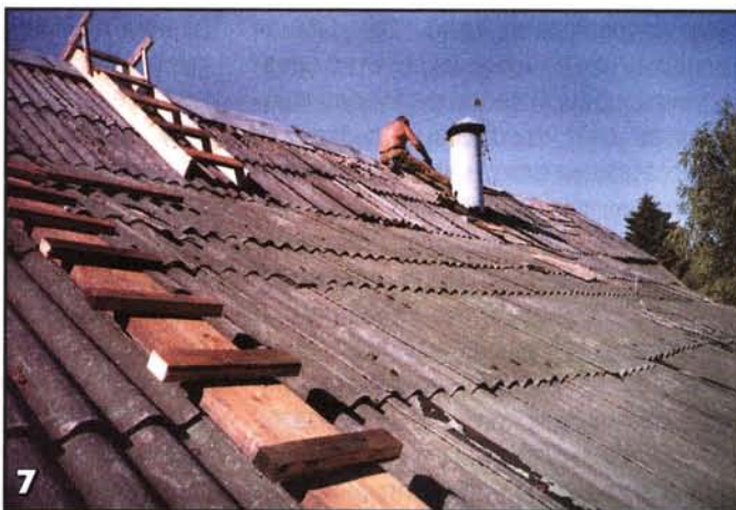
Старая кровля была в удручающем состоянии.
